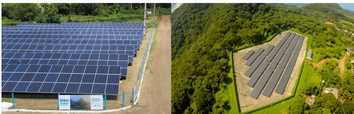
Figura 19. Fotos das usinas solares Noronha I (esq.) e II (dir.). Fonte: CELPE.
