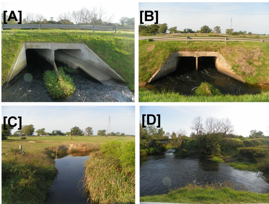
Figura 10: (A) Passa-fauna n° 1 (B) Ausência de passagem seca sob uma das vias (C) e (D) Falta de telamento nas margens da rodovia.
