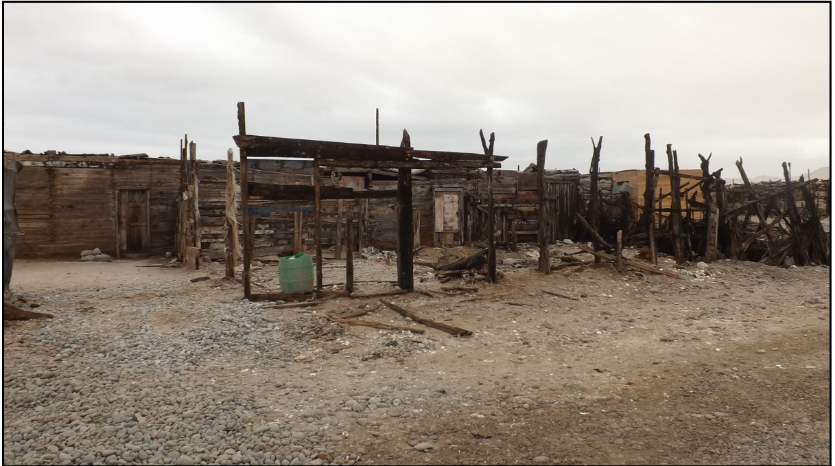
Ilustración 13: Vista lateral de algunos ranchos deteriorados, Sector Ranchería de la Caleta de Laguna Grande
