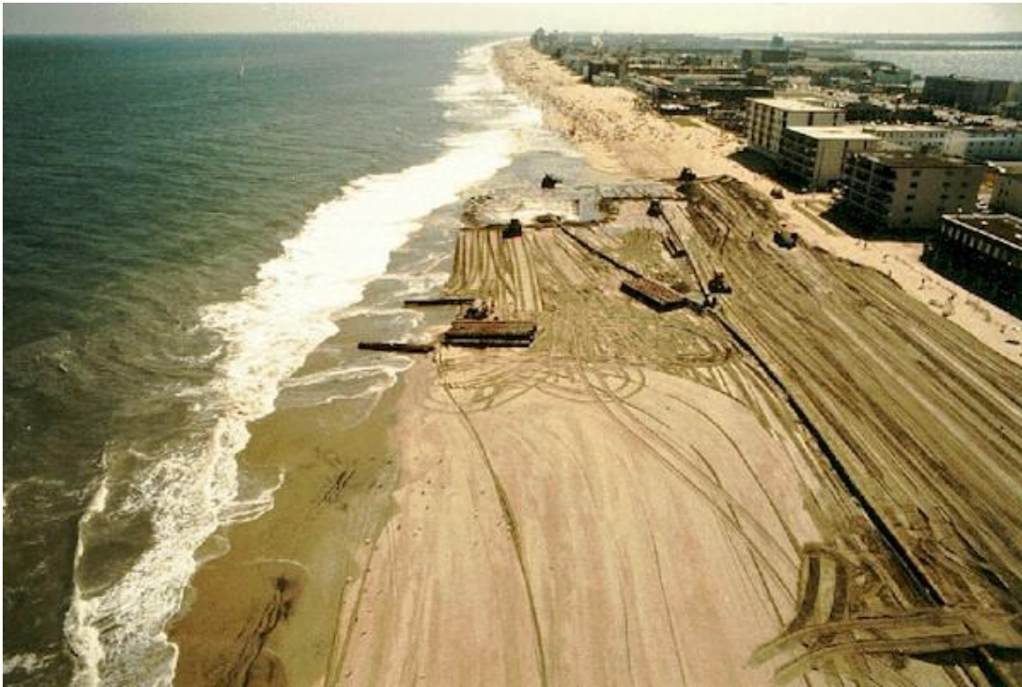
Figura 10 - Projeto de engordamento de praia em New Jersey. Na imagem é possível ver o maquinário atuando no projeto. (Fonte: http://kanat.jsc.vsc.edu/student/davis/index.htm )
