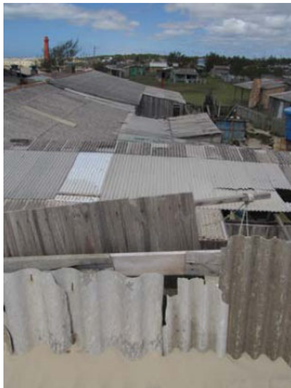
Foto 48: Área de risco socioambiental. Observa-se o soterramento de casas e os riscos com a rede elétrica. (Fonte: Arquivo fotográfico do NEMA)
