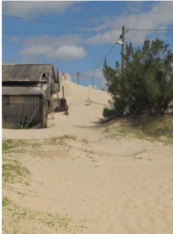
Foto 47: Área de risco socioambiental. Observa-se o soterramento de casas e os riscos com a rede elétrica. (Fonte: Arquivo fotográfico do NEMA)
